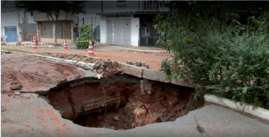
Figura 2 – Vista de cavidade aberta em via pública. Fonte: Portal G1 (2020). Data de publicação da matéria: 07/12/2020.
