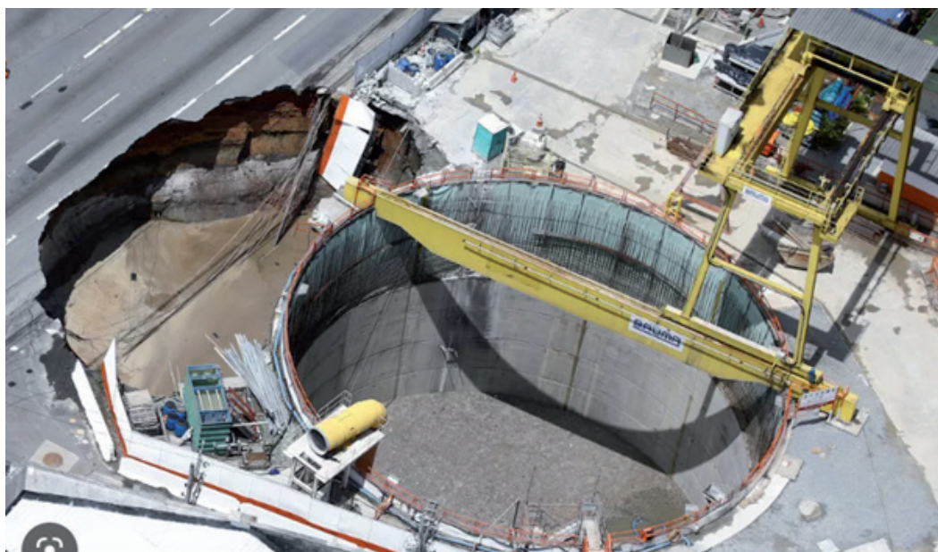
Figura 1 – Vista aérea da região do colapso das obras da Linha 6 do metrô de São Paulo. Fonte: Portal G1 (2022). Data de publicação da matéria: 09/02/2022.
